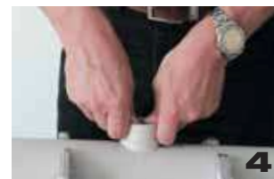
Нагретое седло всунуть в нагретое отверстие зафиксировать примерно на 16 с. Через час систему можно заполнить водой и нагрузить давлением.
